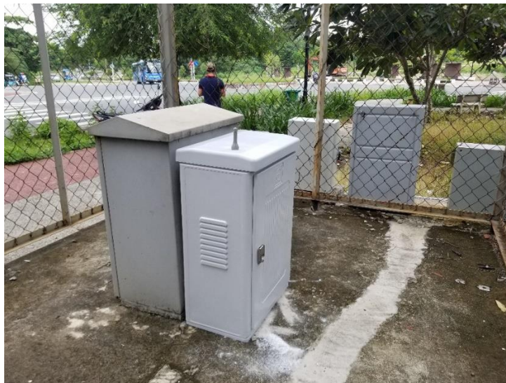
Hình 1. 7 - Tủ điện chiếu sáng thông minh
